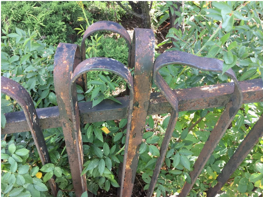
Fot. 5. Reduta Raszyńska - Figura Matki Bożej Niepokalanej w Raszynie, detal ogrodzenia z uszkodzonym profilem przęsła, stan aktualny. Autor fotografii: Michał Mojecki, 07.2018.
