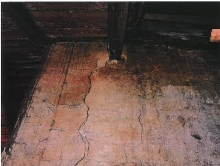
Zdj.2 – strop nad parterem przy klatce schodowej i ścianie zewnętrznej -ślady zawilgocenia długotrwałego więźby dachowej, deskowania i stropu nad parterem
