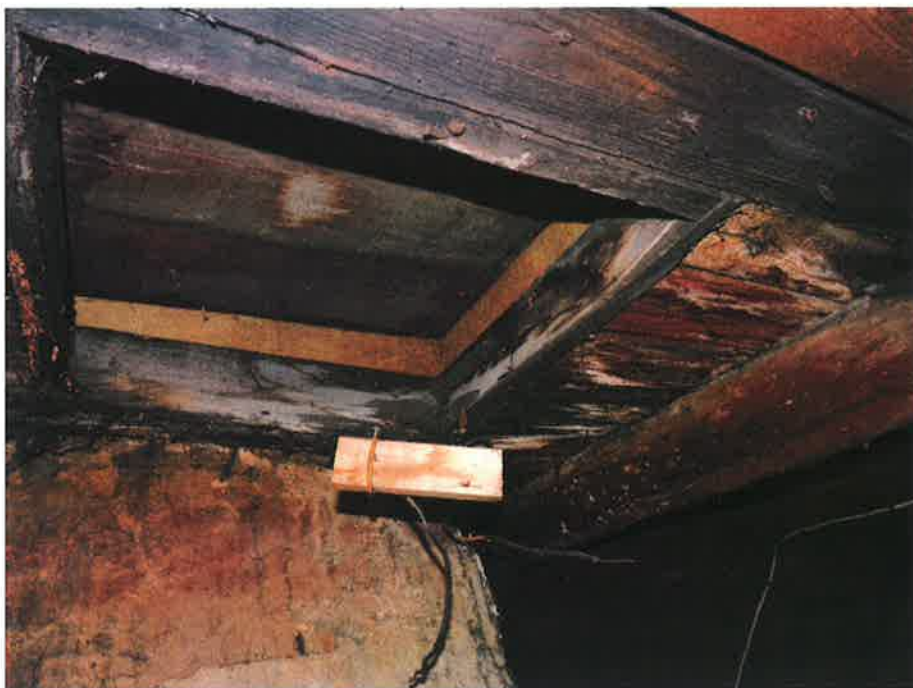
Zdj.3 – wyłaz dachowy -ślady zawilgocenia długotrwałego więźby dachowej, deskowania -ubytki i ślady uszkodzenia krokwi przez owady
