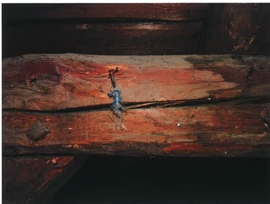
Zdj.5- płatew pośrednia -ślady zawilgocenia długotrwałego deskowania i więźby dachowej -pęknięcie podłużne płatwi
