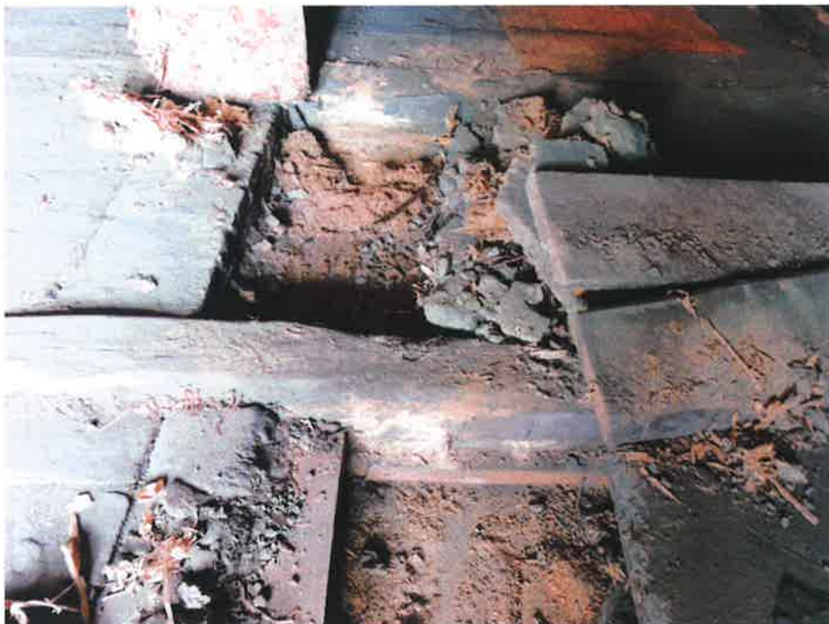
Zdj.4- c. d. strop nad parterem -ubytki i ślady uszkodzenia belki stropowej przez owady
